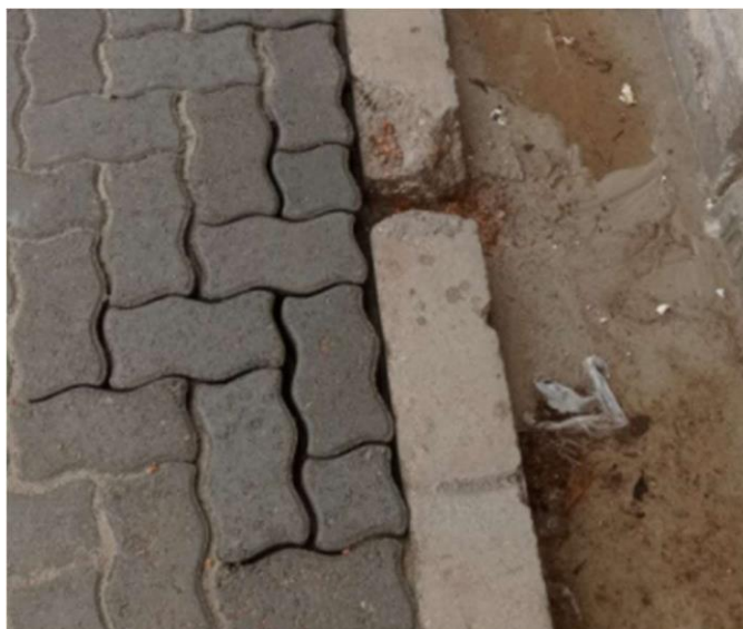
Fugas de arena de asiento de adoquines
