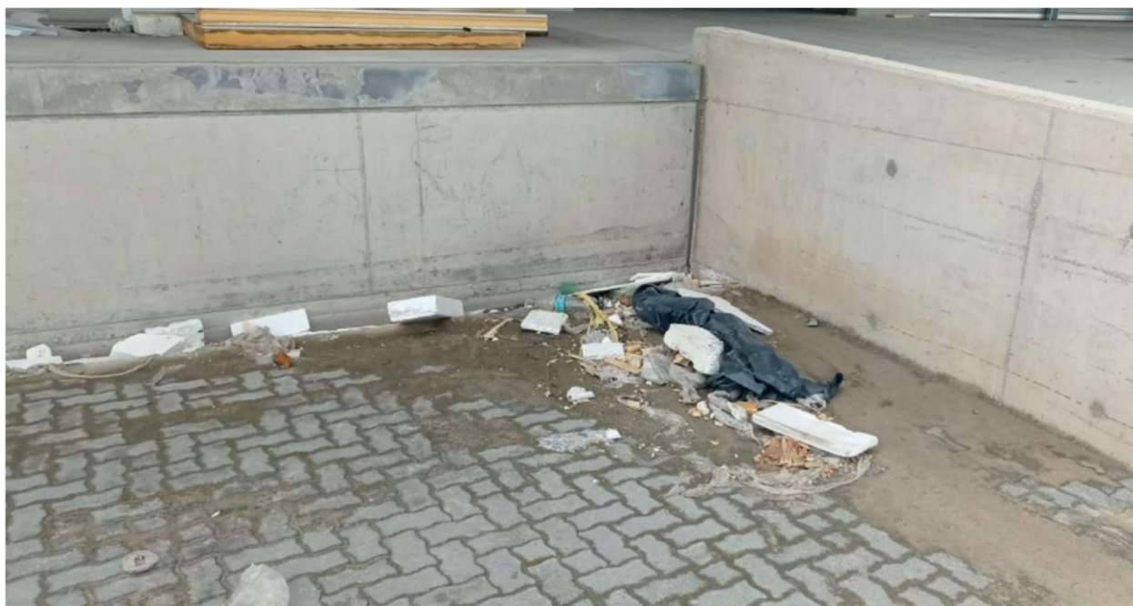
Foto del 8 de febrero de 2021 al Norte de Nave B luego de la lluvia
